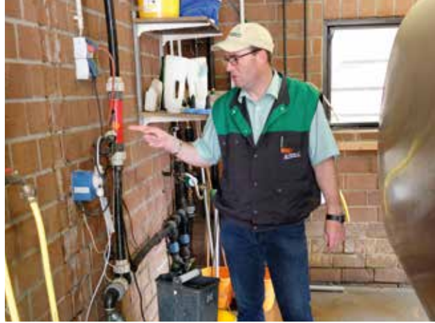
Auch beim Tränkewasser ist Hygiene für den Betrieb ein Muss und der Betriebsleiter setzt auf eine Chlordioxidanlage von Desintec.
