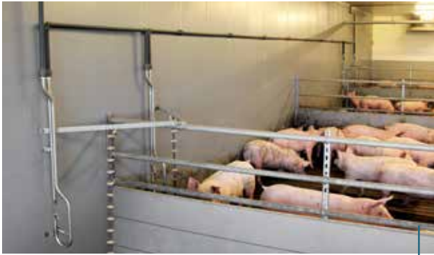
Die Wasserleitungen sind aus Kunststoff und vollständig als Rundlauf konzipiert. So gibt es keine Sackgassen.
