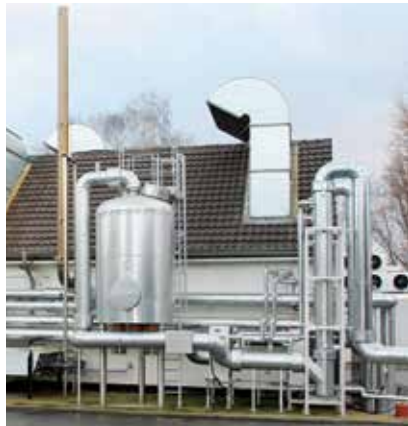
Die BHKW der Altanlage sind in einem bestehenden Gebäude untergebracht.
