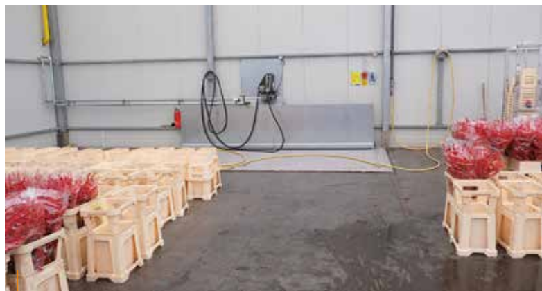
Auch im Gartenbaubetrieb Rouenhoff fügt sich der Tankpunkt unauffällig und bedienerfreundlich in die neue Halle ein.
