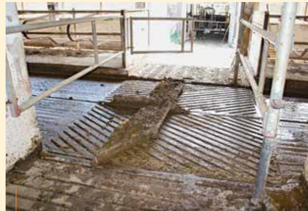
Schieber über Güllerostabwurf – hier muss die Einstreu durch.
